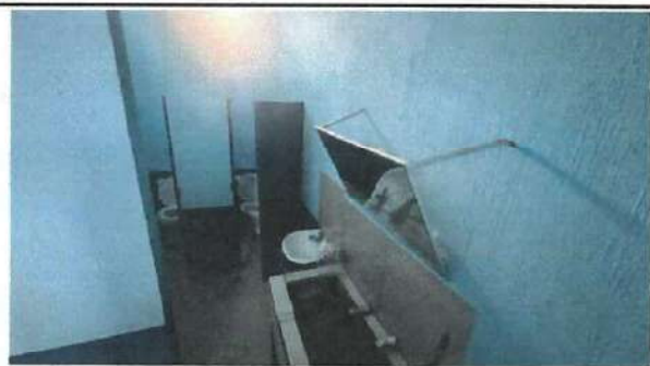
Foto 6: MEJORAMIENTO BAÑOS EN GENERAL - NO PRESENTAN LAS CONDICIONES ADECUADAS PARA NIÑOS (AS)
