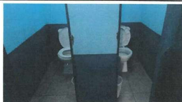
Foto 4: MEJORAMIENTO DE SANITARIOS - ESTOS SON MUY ALTOS PARA LAS NIÑOS (AS)
