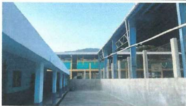
Foto1: MEJORAMIENTO DE PATIO - NO CUENTA ENTECHADO
