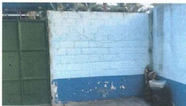
Foto 2: MEJORAMIENTO MURO PERIMETRAL - EL MURO PRESENTA GRIETAS
